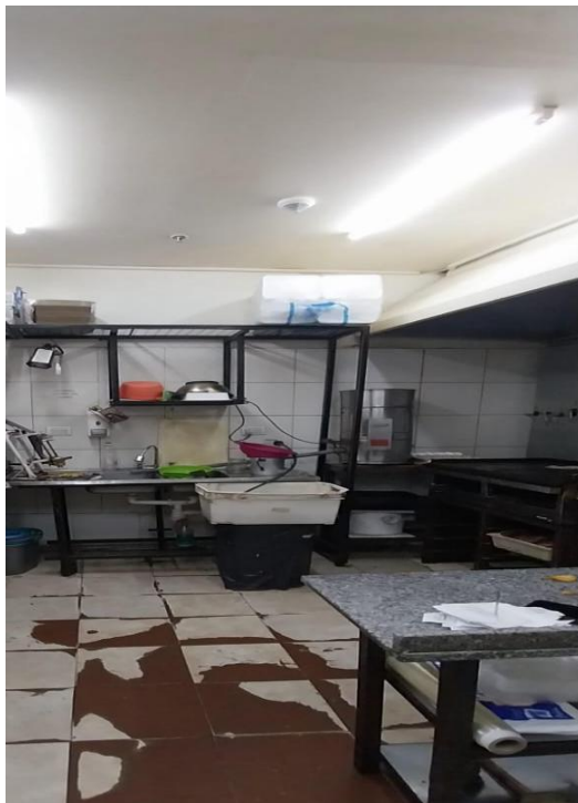
Cocina, pisos agrietados, luces sin protección
